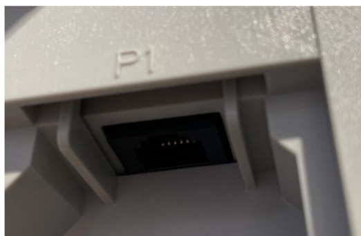
Figuur 5: P1-poort op de slimme stroommeter voor aansluiten P1-meter
